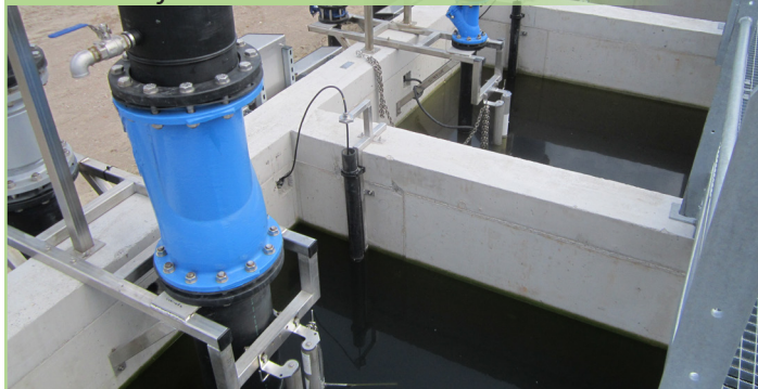
Nouvelle infrastructure de rejet d'effluent, de recirculation des boues et d'évacuation des matières flottantes
