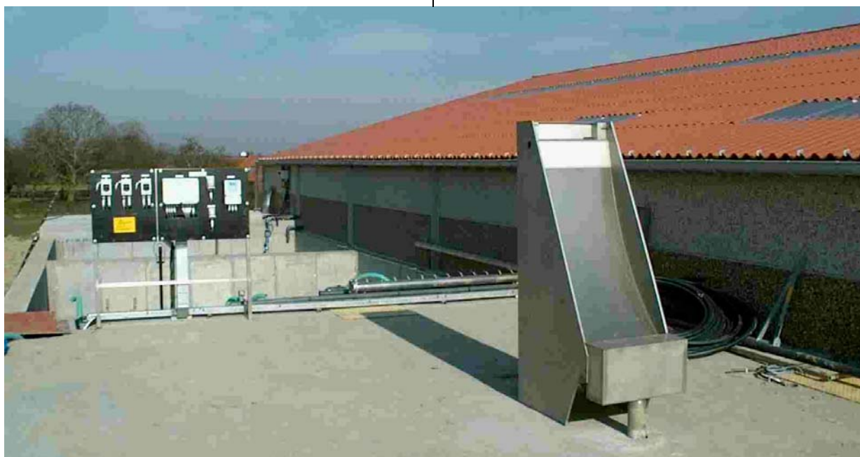
Foto: Mestverwerkingsinstallatie bij Dhr E. Van Wonterghem
