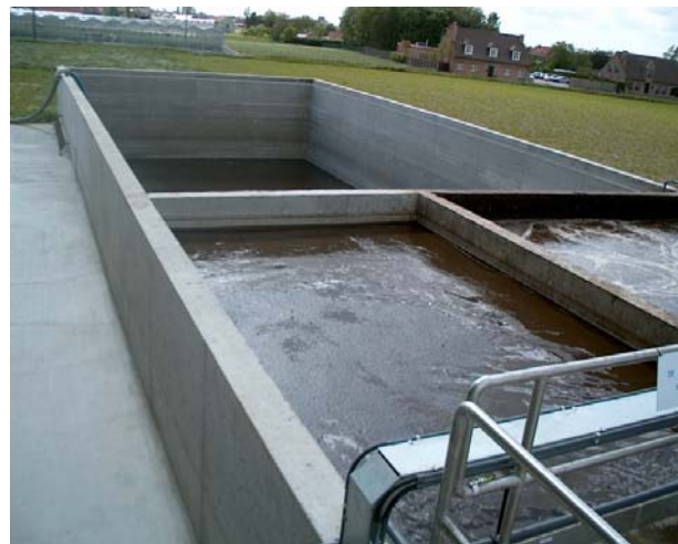
Foto: Biologie bij Varfome met op de voorgrond het denitrificatie- (links) en het nitrificatiebekken (rechts) en op de achtergrond het effluentbekken
