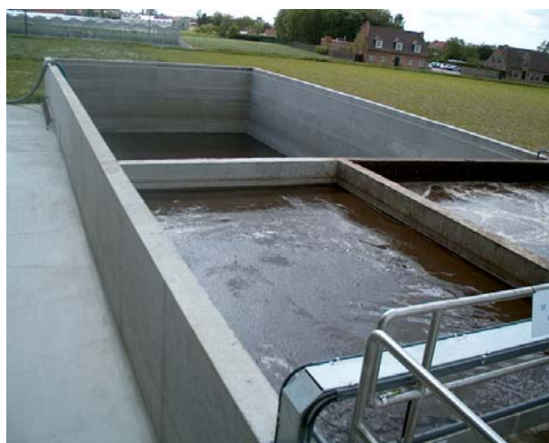
Foto: Biologie bij Varfome met op de voorgrond het denitrificatie- (links) en het nitrificatiebekken (rechts) en op de achtergrond het effluentbekken. Deze drie bekkens moeten niet meer overdekt worden.
