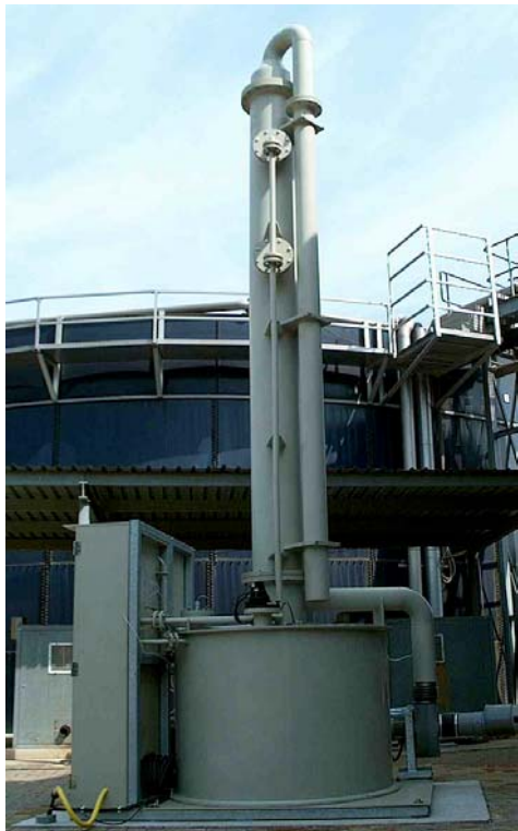
Foto: Pilot-luchtwasser, kan gebruikt worden als zure of als biologische wasser
