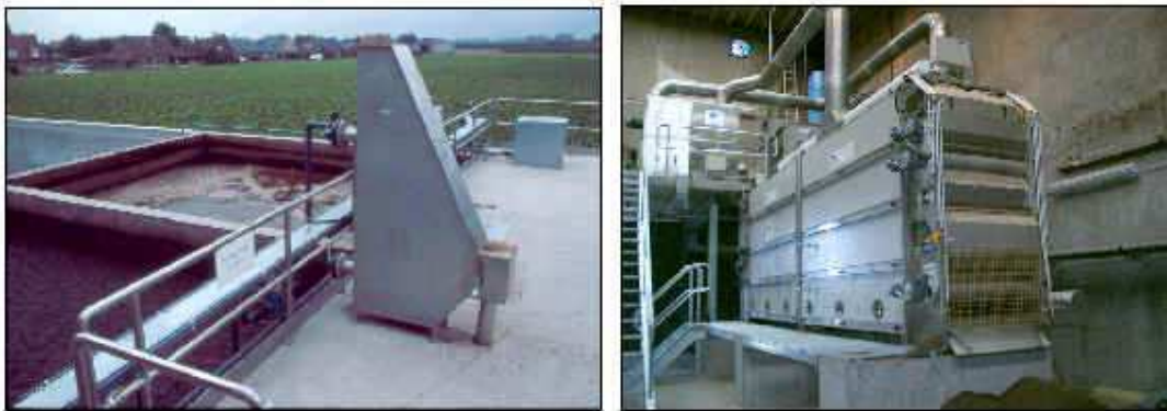
Figuur 1. Biologische zuiveringsinstallatie voor de dunne fractie (links) en condensatiedroging voor de dikke fractie (rechts), beide volgens de Trevi-technologie
