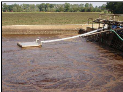
Foto 1. Lindvallbox op nitrificatiebekken
