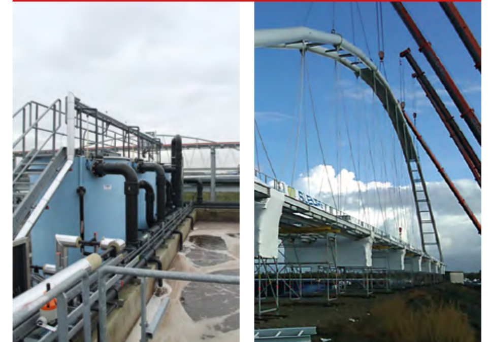
Een engineeringproject zoals we er te weinig hebben in België: AMORAS. Bemerkt links de continue zandfilters en rechts het baggerportiek - in opbouw - boven de indikvijvers. Afmetingen: 175 meter lang, 25 meter hoog.
