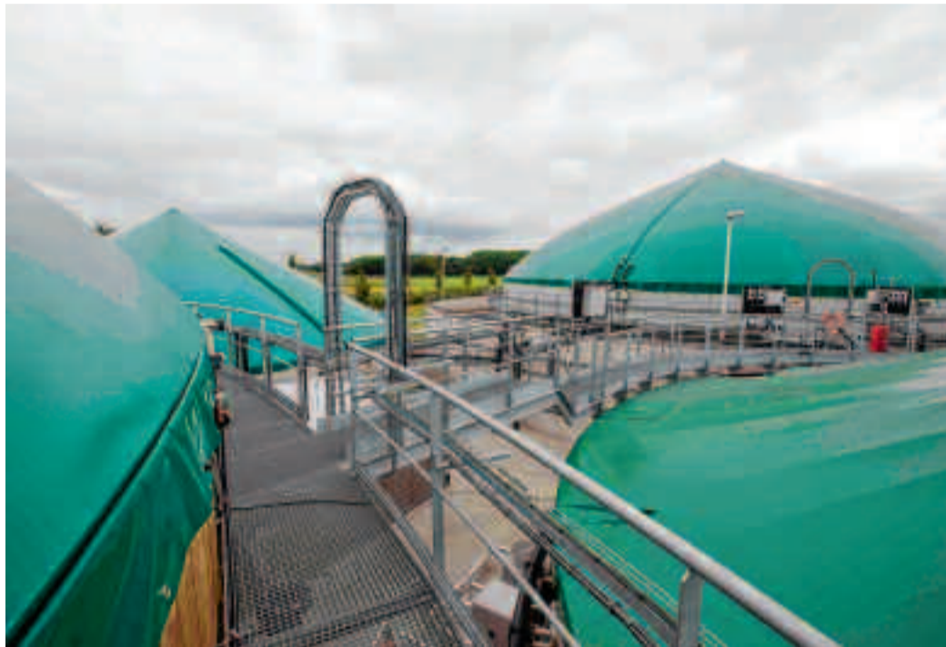
De bestaande waterzuivering van Ardo werd uitgebreid met een anaerobe voorbehandeling. (foto: Ardo)
