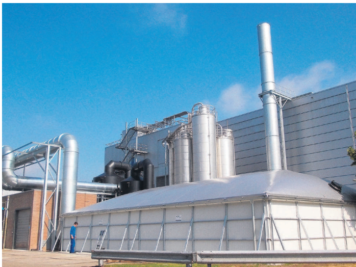
Trevi-luchtzuiveringsinstallatie voor het Nederlandse bedrijf IFF
