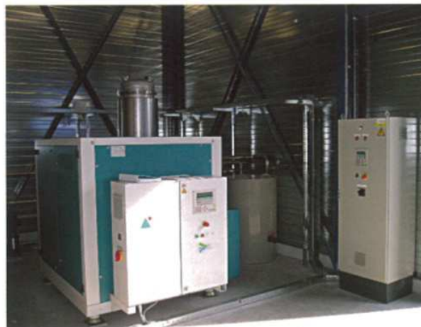
Deelstroombehandeling via vacuümdamper met hergebruik van condensaat
