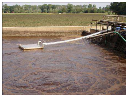
Foto 1. Lindvallbox op nitrificatiebekken
